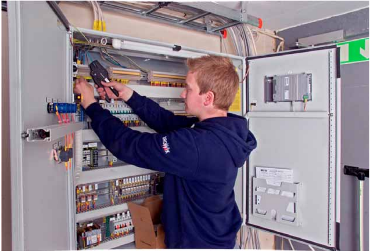
Foto: Elektriska installatörsorganisationen, EIO
