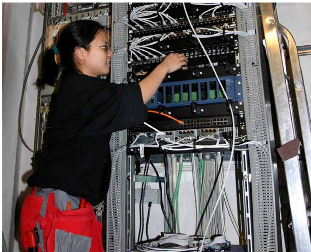
Foto: Elektriska installatörsorganisationen, EIO
